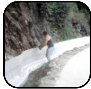
Road edge drain
